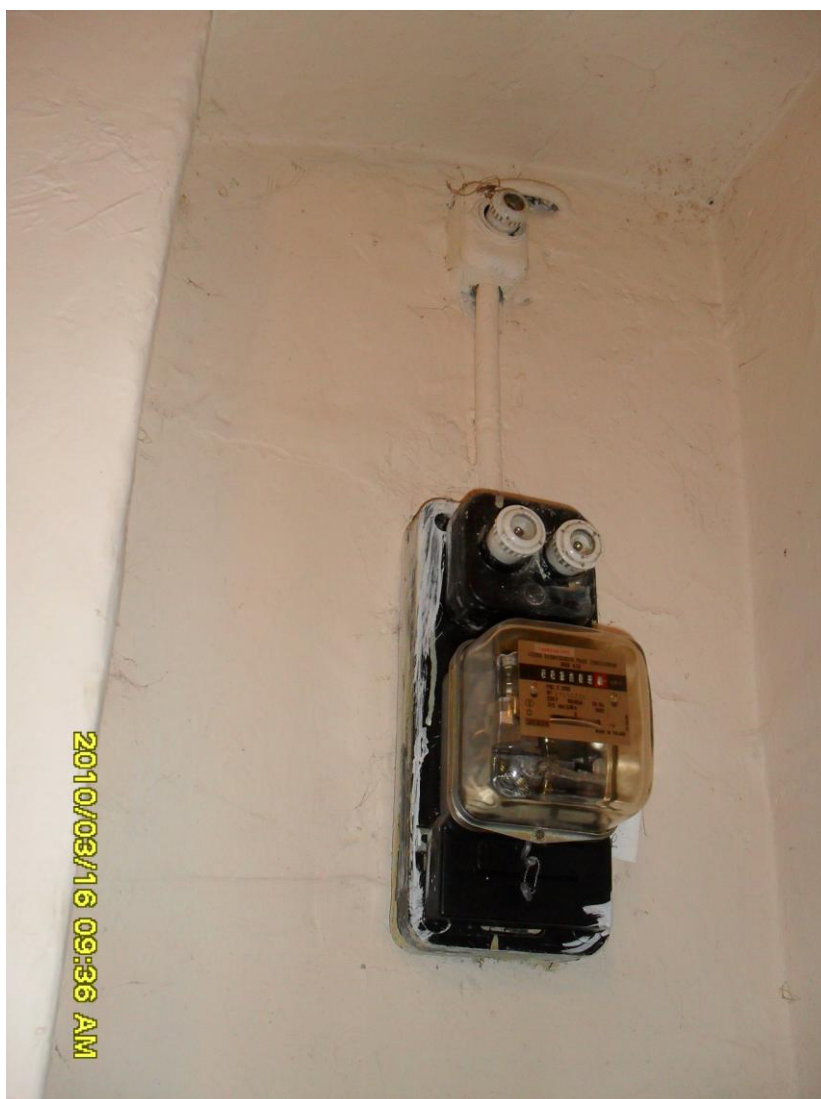
fot. Istniejący układ pomiarowy 1-f.
