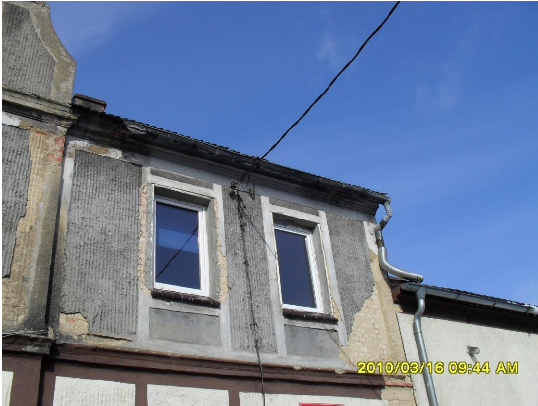
fot. Przyłącze do budynku.
