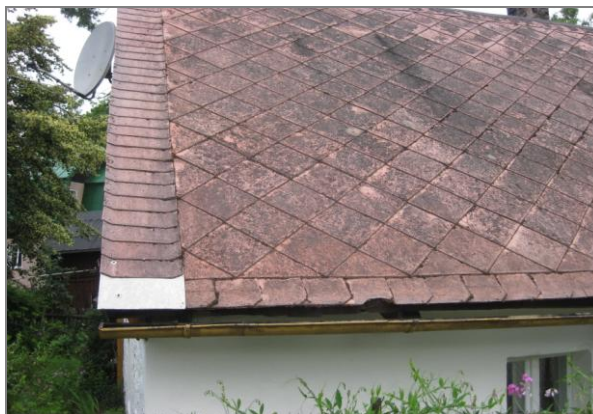
Fot. 2 Płyty azbestowo-cementowe płaskie
