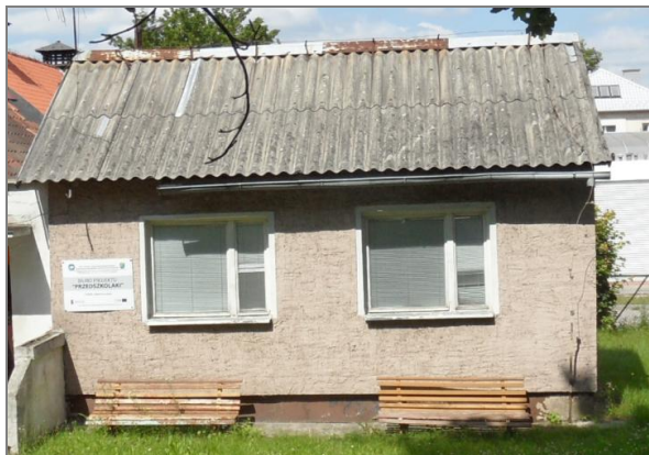
Fot. 1 Płyty azbestowo-cementowe faliste
