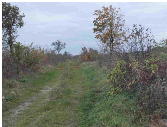
Fot. 31 Droga utwardzona w złym stanie w Trzebnicach
