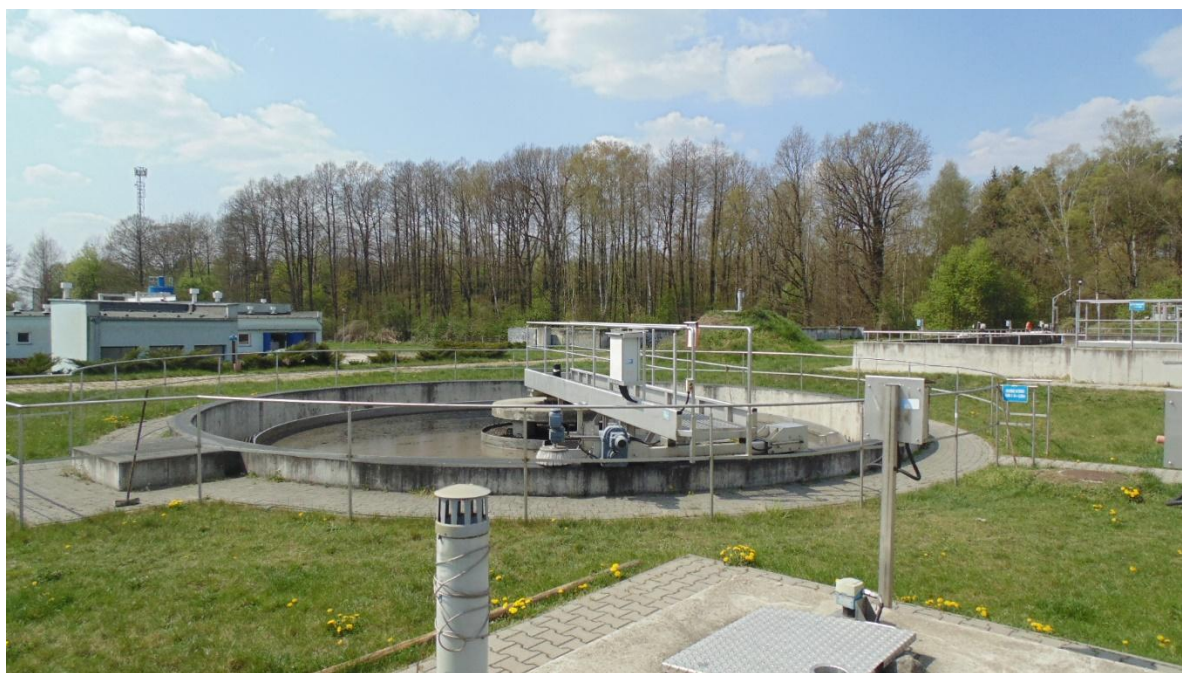
Rysunek 7 Osadnik wtórny oczyszczalni ścieków w Chocianowie
