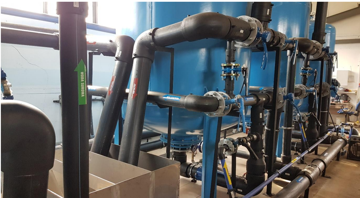
Rysunek 4 Układ uzdatniania wody ZUW Brunów
