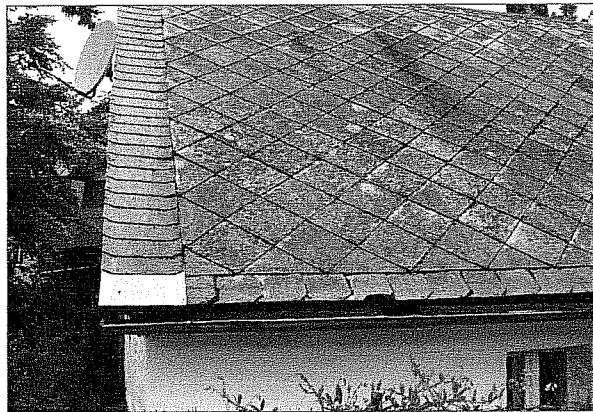
Fot. 2 Płyty azbestowo-cementowe płaskie
